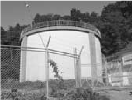
1500tを常備する河和田第2配水池
